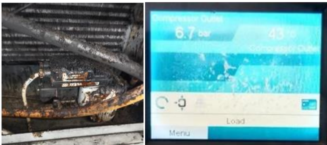
Gambar 2. Kebocoran jalur kondensat ke auto drain Atlas Copco ZT 45
