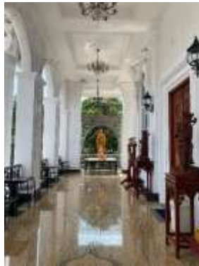
Gambar 10. Lampu Gantung, Downlight dan Lampu Dinding di Lantai 3 Vihara
